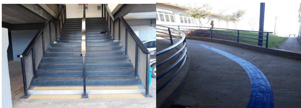
Figura 34 - Sinalização tátil de alerta, escada anexo C, guia de balizamento anexo B.
