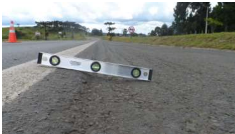
Figura 19 – Desnível entre pista e acostamento
