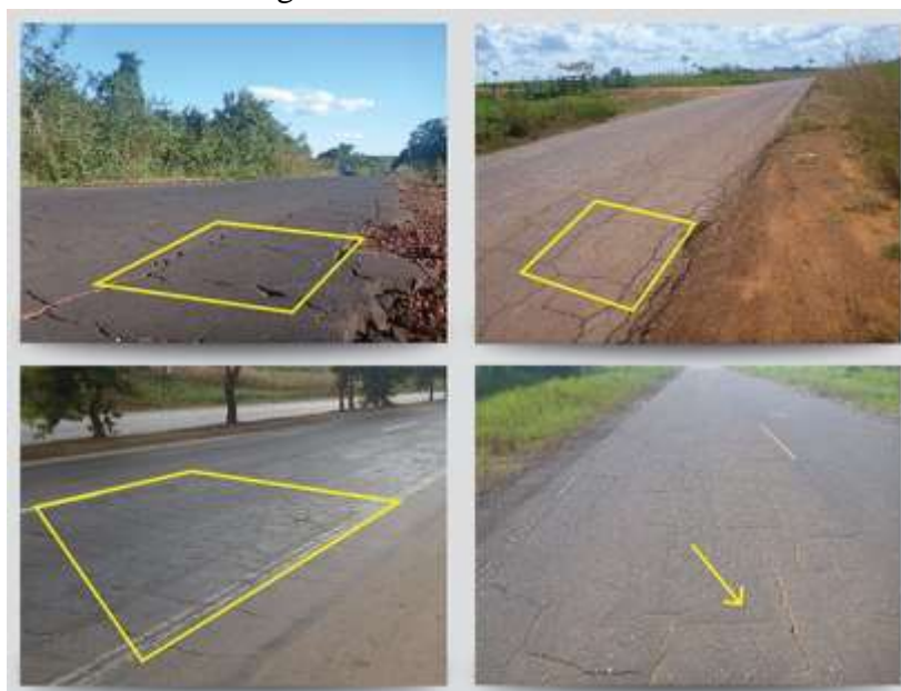
Figura 11 - Trincas em Bloco.
