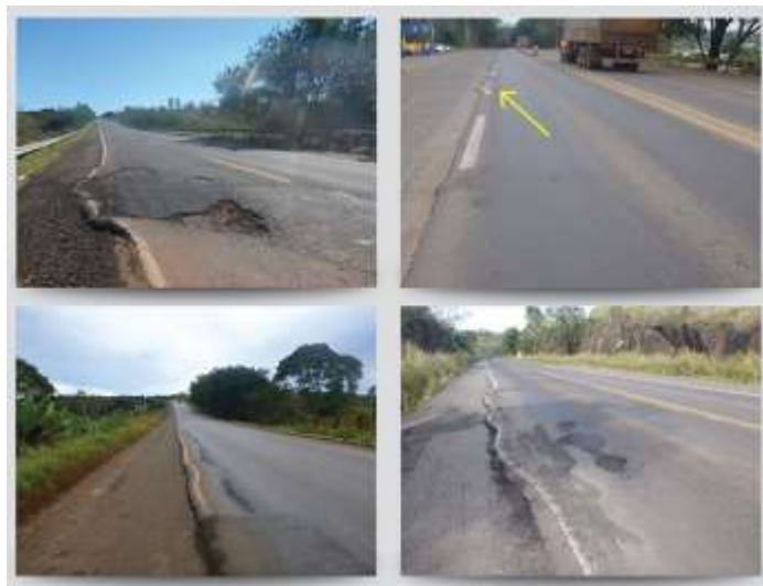
Figura 14 - Escorregamento do Revestimento.
