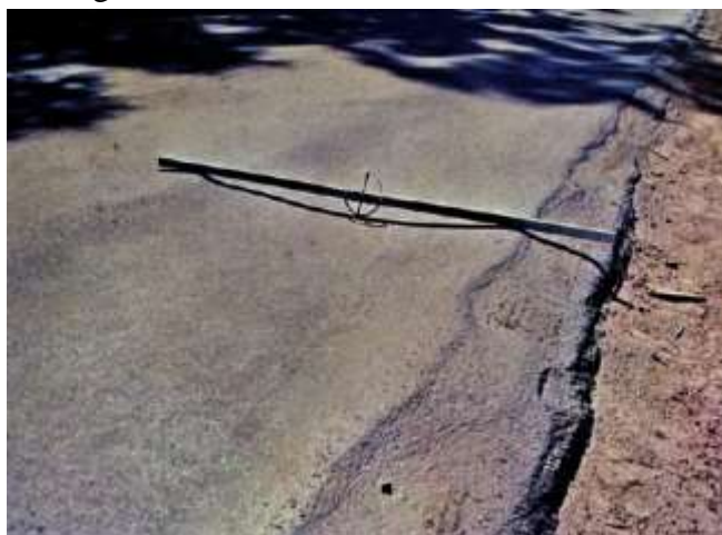
Figura 12 - Afundamento na trilha de roda.
