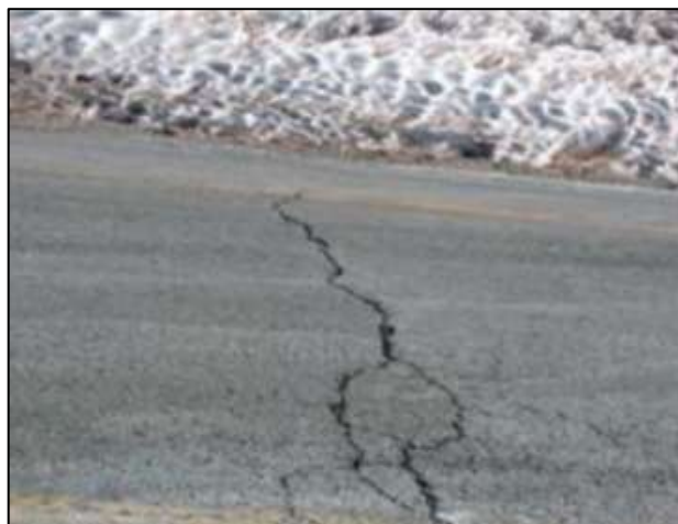
Figura 9 - Trinca de retração térmica.
