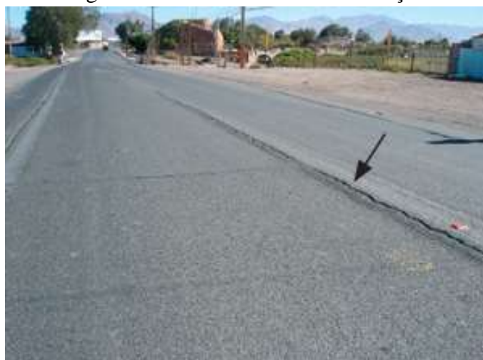
Figura 10 - Trincas Isoladas de Retração.
