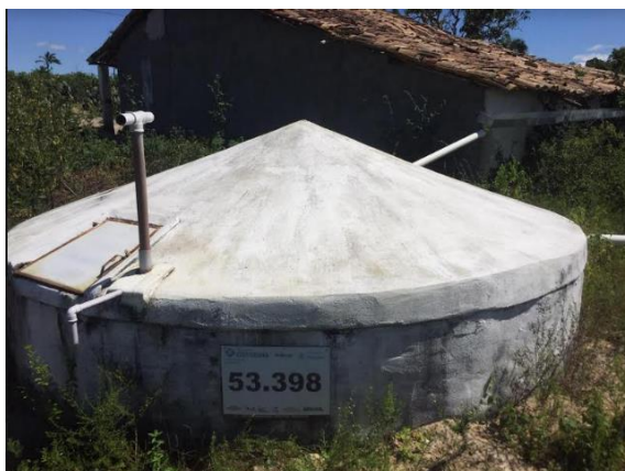
Figura 8- Cisterna construída pelo programa cisternas.
