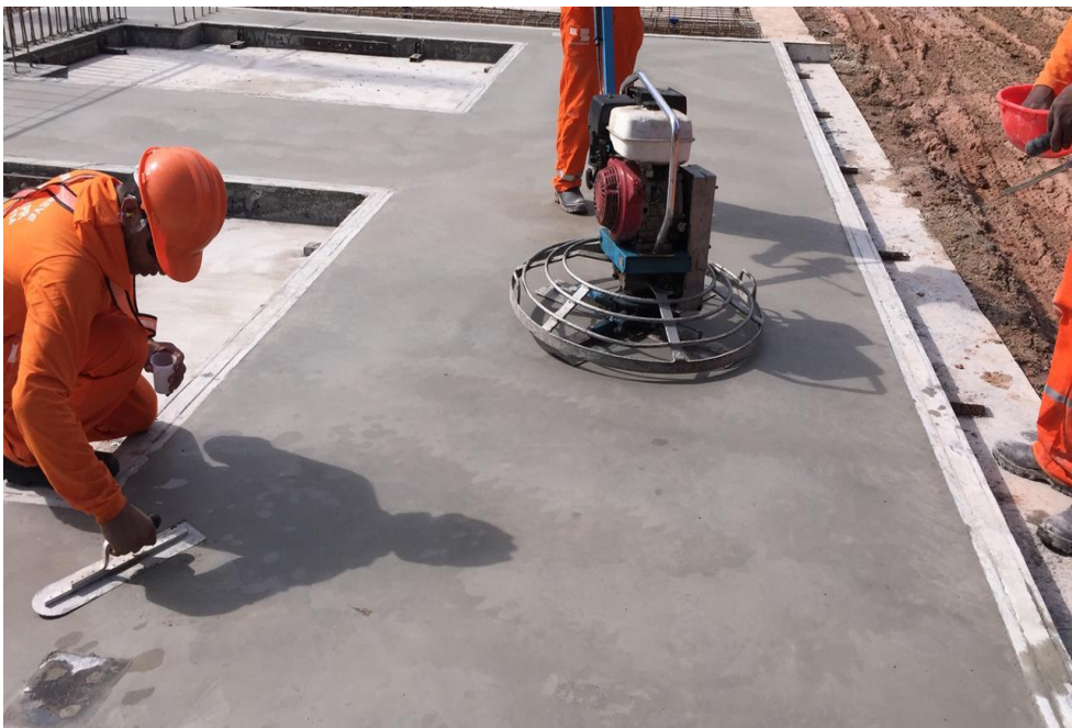
Figura 32: Superfície do painel totalmente lisa. Fonte: (O autor, 2018)
