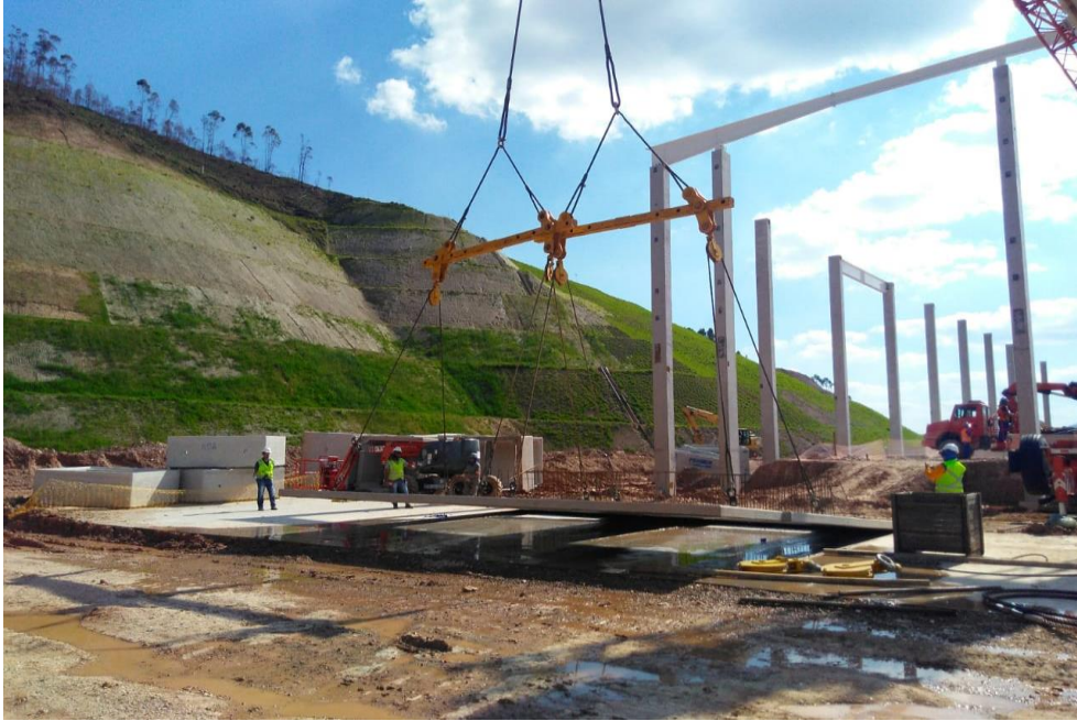
Figura 33: Após o tempo de cura e com resistência máxima, o guindaste começa a levantar a parede tilt-up. Fonte: (O autor, 2018)
