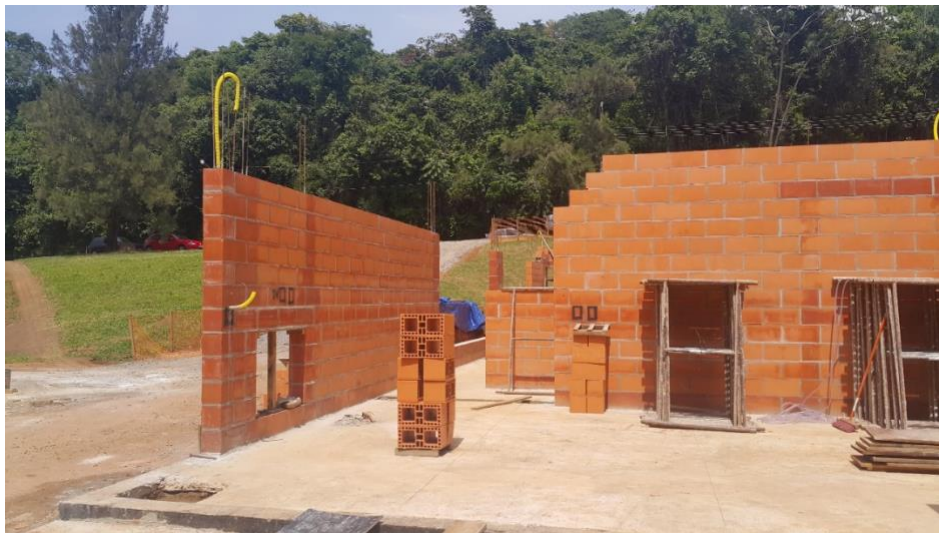
Figura 24, Parede sem blocos com furo para interruptores, Fonte: O autor (2018)
