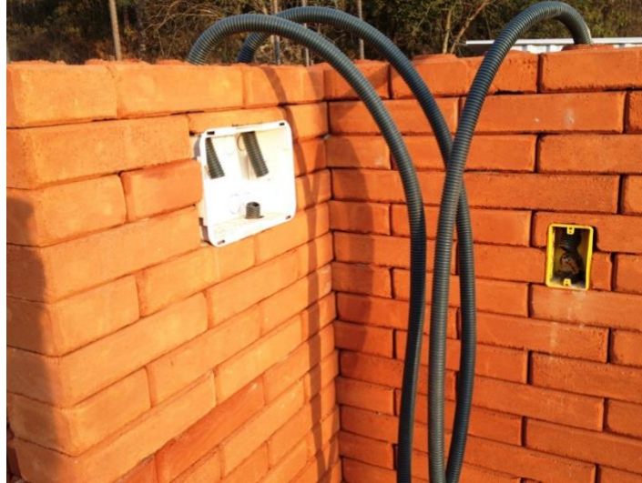
Figura 15, instalação elétrica, Fonte: www.tijolosecologicostrindade.com.br (2018)
