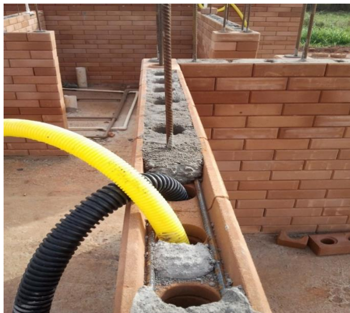
Figura 14, instalação elétrica, Fonte: http://www.tijolosecologicostrindade.com.br (2018)
