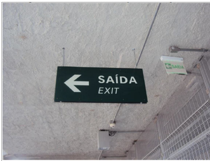
Figura 1 - Placa de sinalização de emergência.
