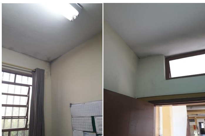
Figura 9- Manchas na parede da sala de coordenação
