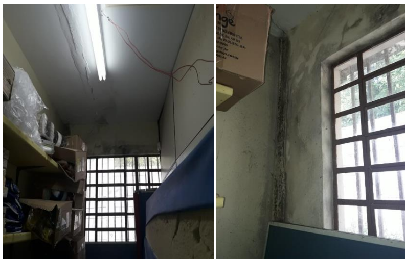
Figura 12- Bolhas na pintura e manchas na parede do almoxarifado.
