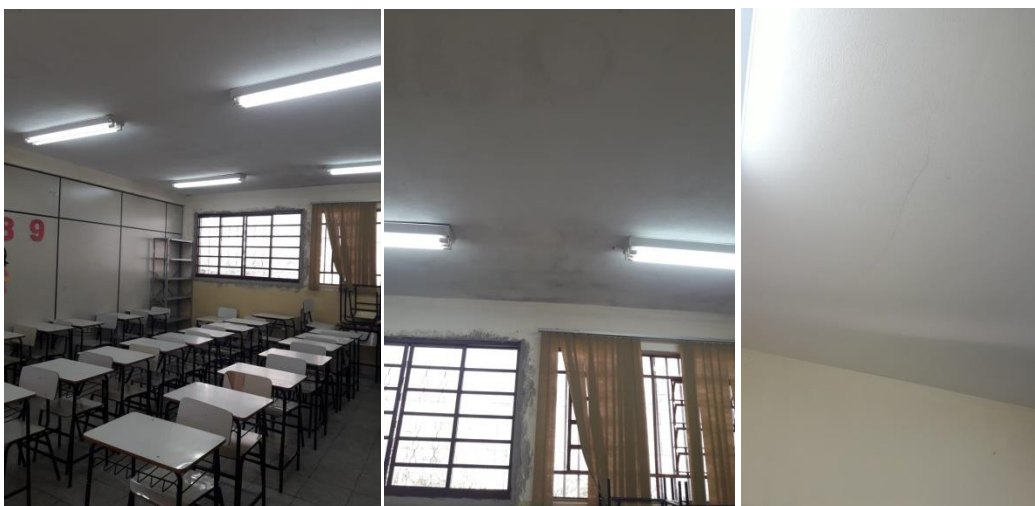
Figura 6- Fissuras e manchas no teto.
