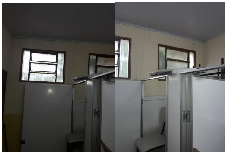
Figura 7- Manchas na parede do vestiário
