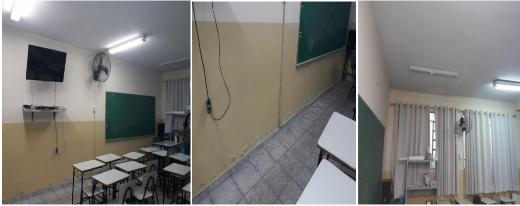
Figura 10- Paredes descascadas na sala de multimídia.
