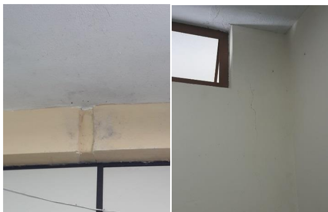
Figura 8- Manchas na parede da sala do núcleo de educação
