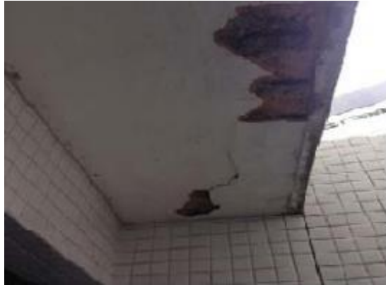
Figura 2- Corrosão em estruturas de edificações.
