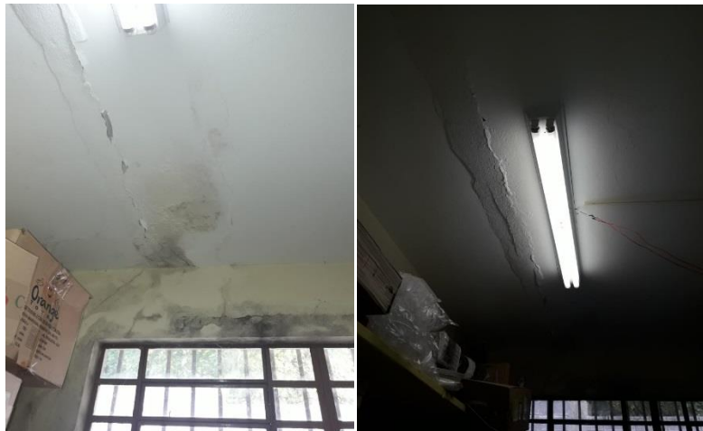
Figura 11- Manchas e infiltrações no teto do almoxarifado.
