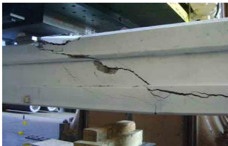
Figura 5- Trincas causadas pela tensão de cisalhamento.
