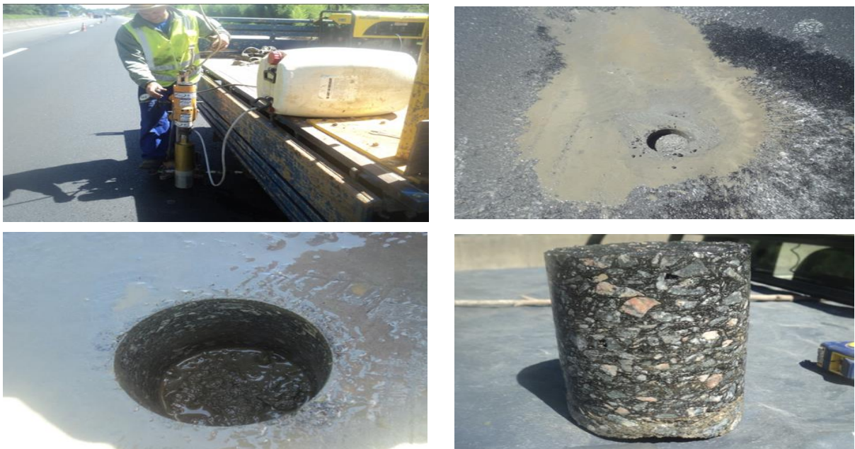
Figura 7 - Processo de extração de CP (corpo de prova) p/ análise das camadas do pavimento.
