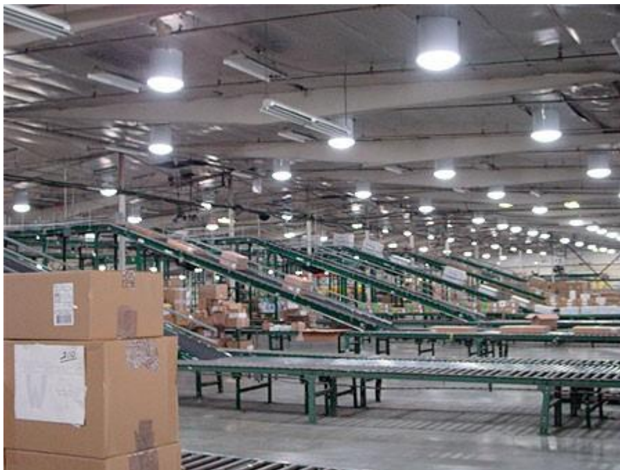
Figura 9: Iluminação tubular solar. Fonte: techne.pini.com.br .
